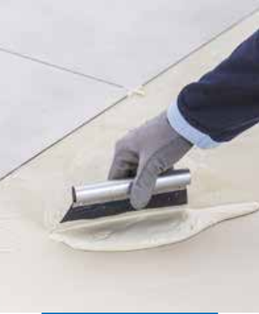
Auftragen von Ultrabond Eco 4 LVT und Verklebung von LVT mit breiten Fugen und Fugenkreuzen
